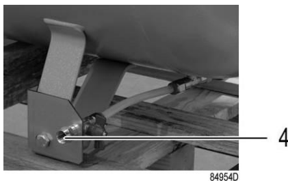
Ventil vypouštění kondenzátu na vzdušníku
